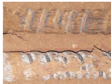
图 3 GFRP 筋-混凝土界面破坏形态
